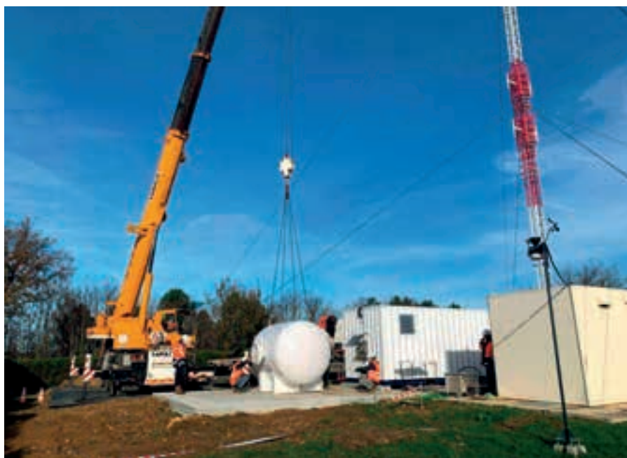
Le Projet Sepher a pour objectif de remplacer des groupes électrogènes diesel par une solution verte basée sur de l'hydrogène local et renouvelable. L'énergie produite par cette installation hydrogène permet d'alimenter les antennes isolées nécessaires à l'aiguillage des avions civils.
