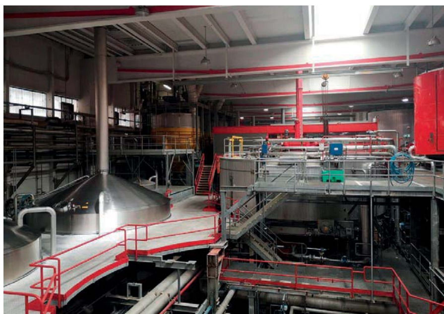
L'usine Kronenbourg d'Obernai. La nouvelle installation biomasse permettra d'effacer complètement le gaz du site.
